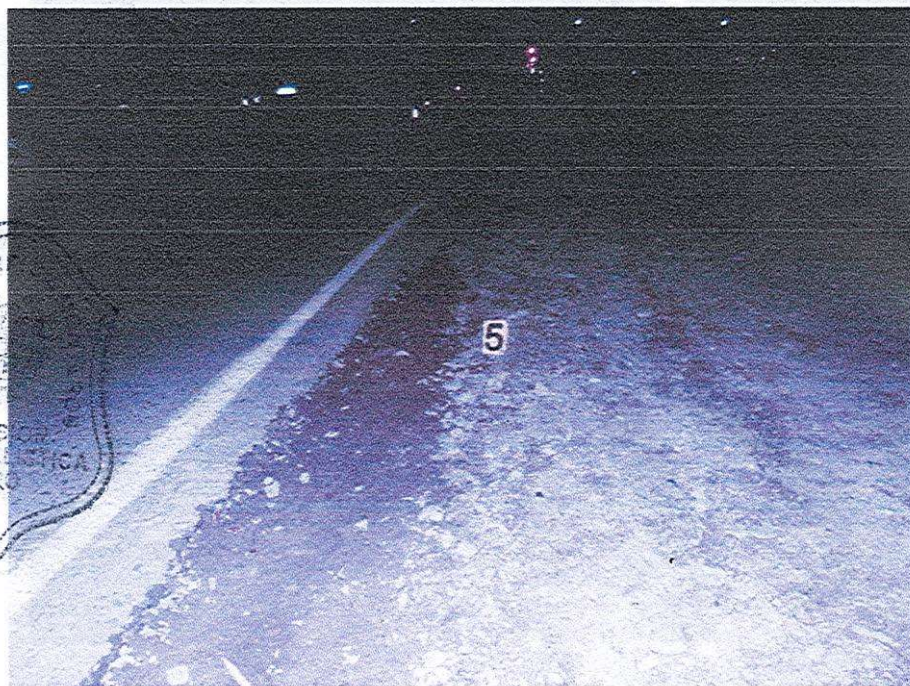
FOTOGRAFIA N° 10: Realizada en secuencia se observa cartel n°5 alteraciones en la banquina enripiada.-
