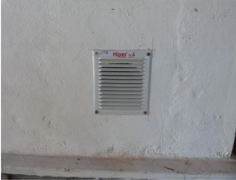
FOTOGRAFIA N° 04: Toma en primer plano a la rejilla de ventilación observándose que la misma es de reciente data y se puede observar marcas de lápiz al costado de la rejilla de ventilación.-
