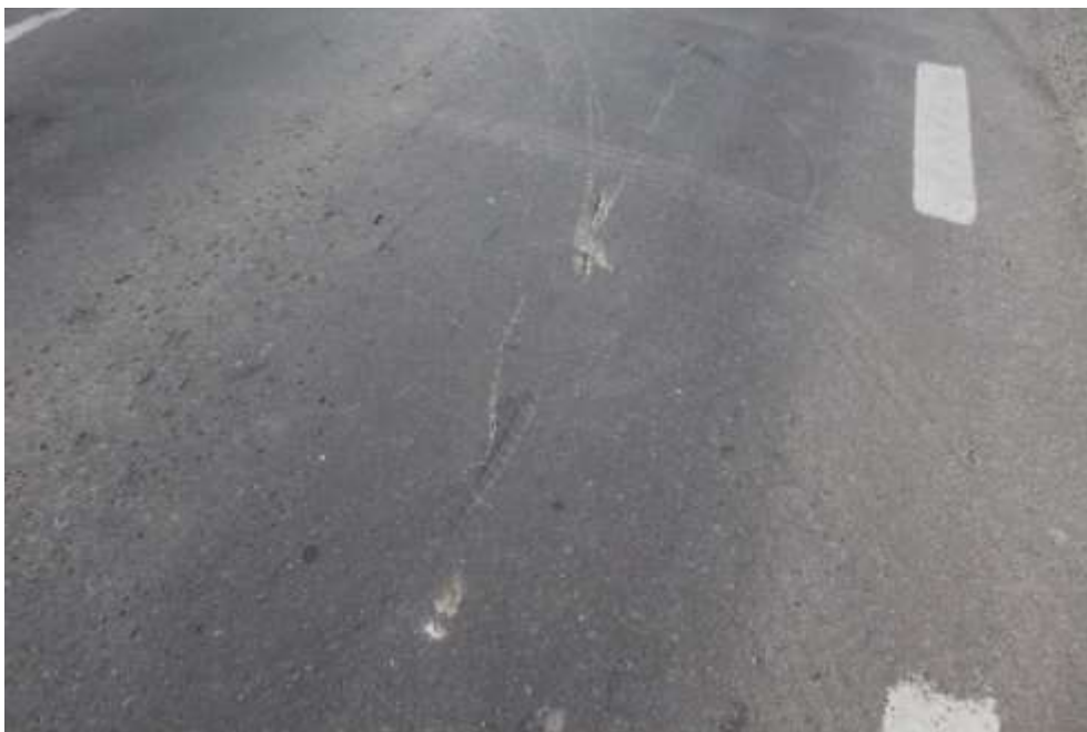
Fotografía n°38: En detalle a las fricciones antes mencionada. -
