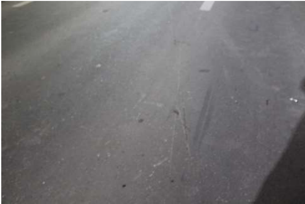
Fotografía n°46: En aproximación a las fricciones metálicas antes mencionadas. -
