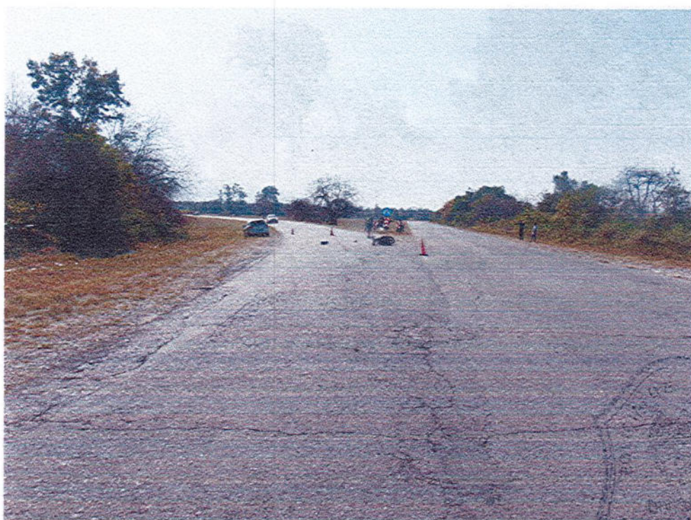
FOTOGRAFIA N° 01: Toma realizada en forma panorámica desde el cardinal Sur a Norte sobre Ruta Provincial n° 304 donde se observa el lugar donde se habría producido el hecho.-
