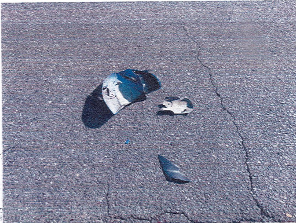
FOTOGRAFIA N° 06: Toma en aproximacion donde se observa restos plásticos en el pavimento.-
