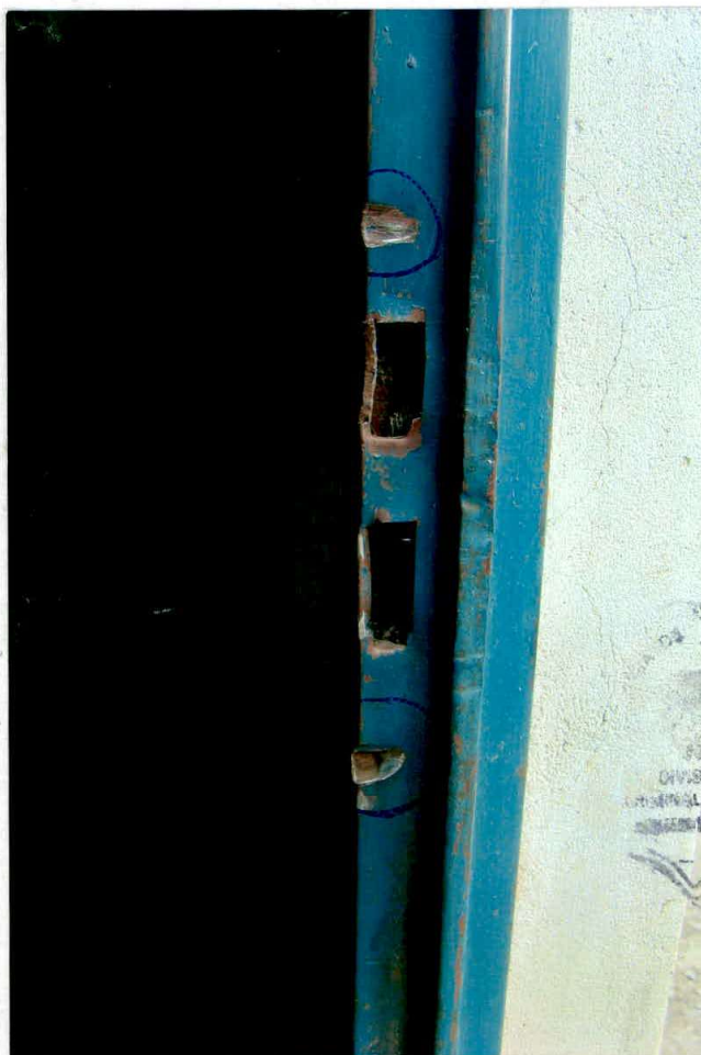
FOTOGRAFIA N ° 7: En forma // Parcial se observa marco de la puerta con marca de violencia .-
