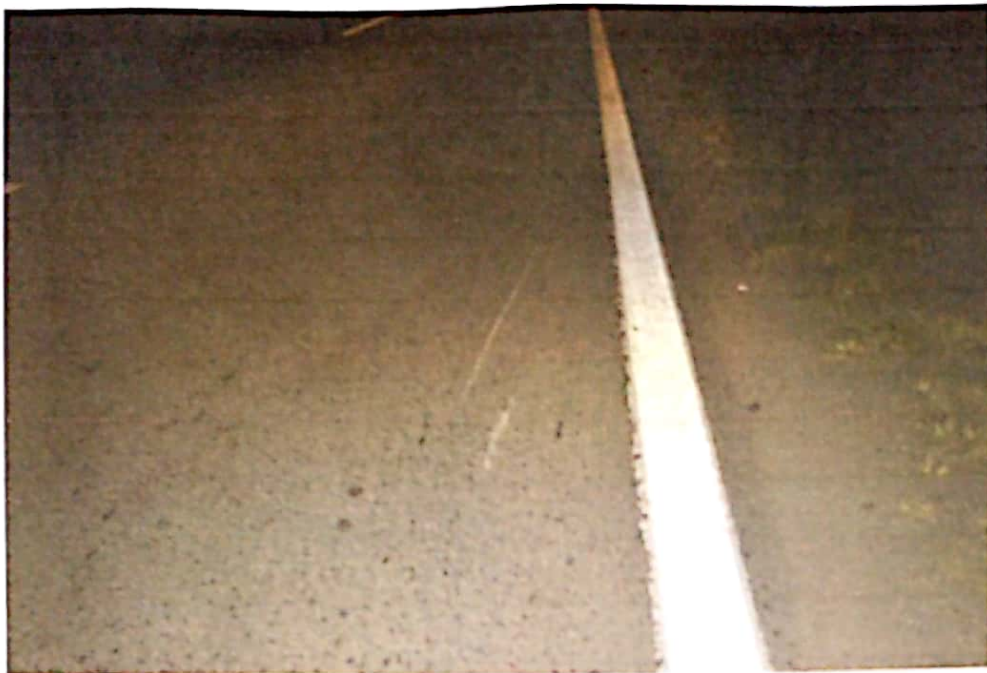
Fotografía n°6: En aproximación, se observa marca de fricción.-
