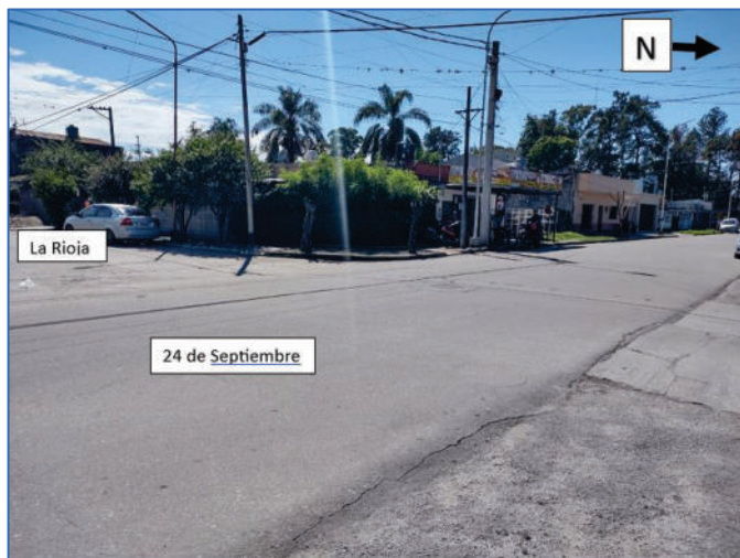
Fig. N° 2: Estado del pavimento en la intersección de La Rioja y 24 de Septiembre
