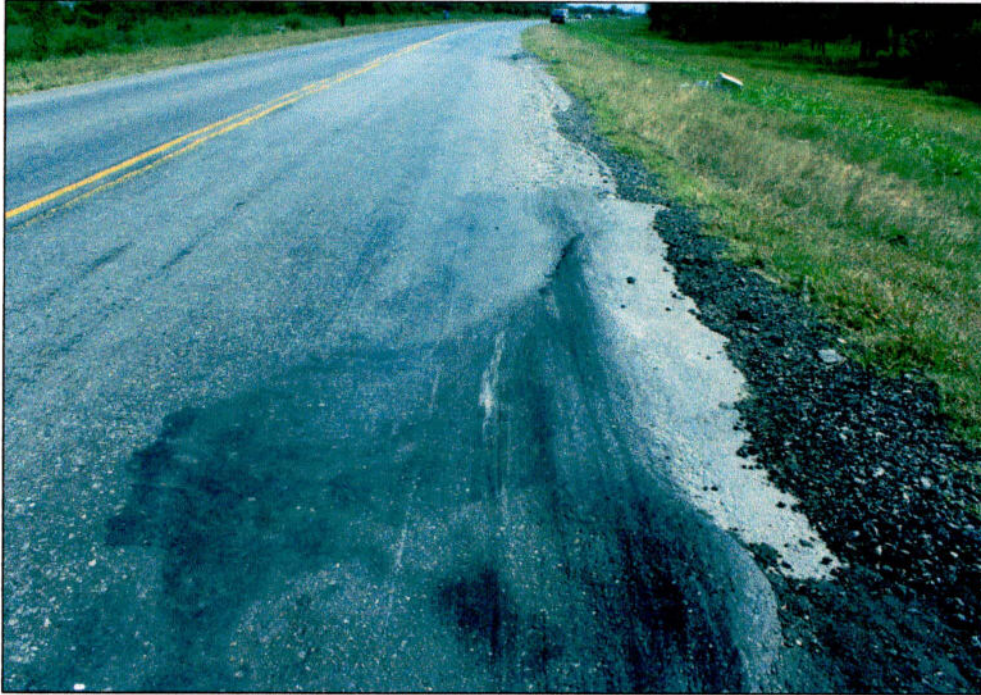
Fotografía n° 4: en detalle el bache se observa la fricción
