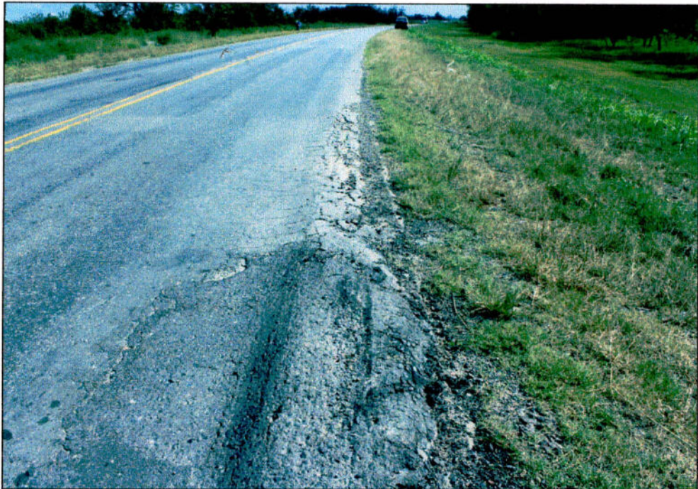
Fotografía n° 7: muestra otro bache se observa huellas de fricción
