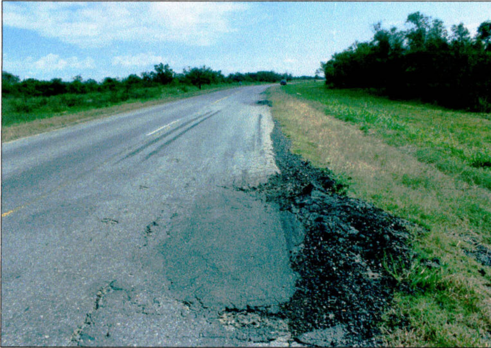
Fotografía n° 2: en detalle uno de los baches
